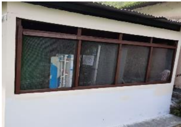
Foto 3. Pintura en ventana de madera - restaurante
