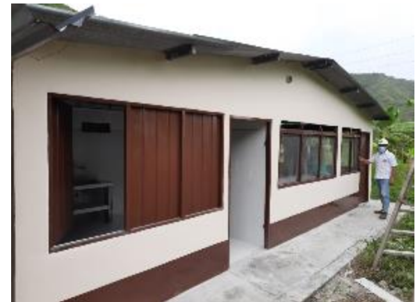
Foto 4. Pintura exterior en muros - cocina
